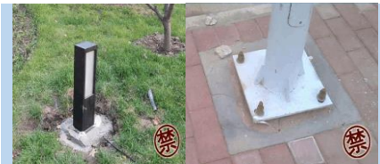
基础外露,无绿化收口
