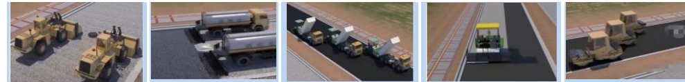
基层施工 透层油撒布 混合料摊铺初压 面层摊铺复压 终压养护
