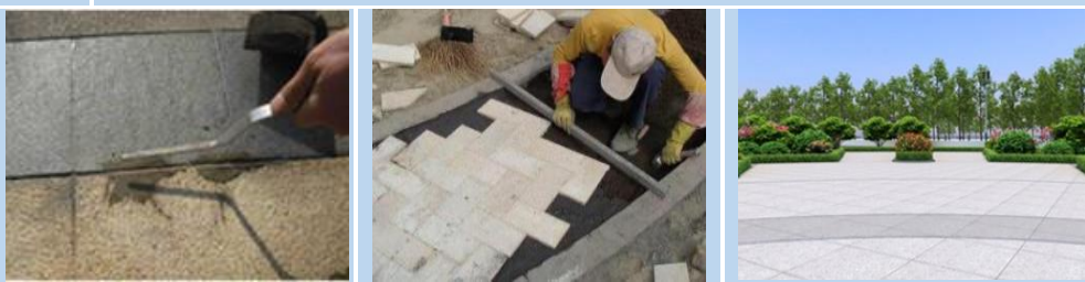
防止板面基层出现空鼓 铺贴应倒退进行避免错缝 间隙均匀平整，图案清晰
